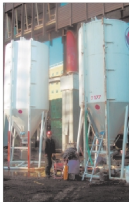
SILOER. Fra siloene pumper en 195 meter lang slange A-Plan opp til 21. etasje.
